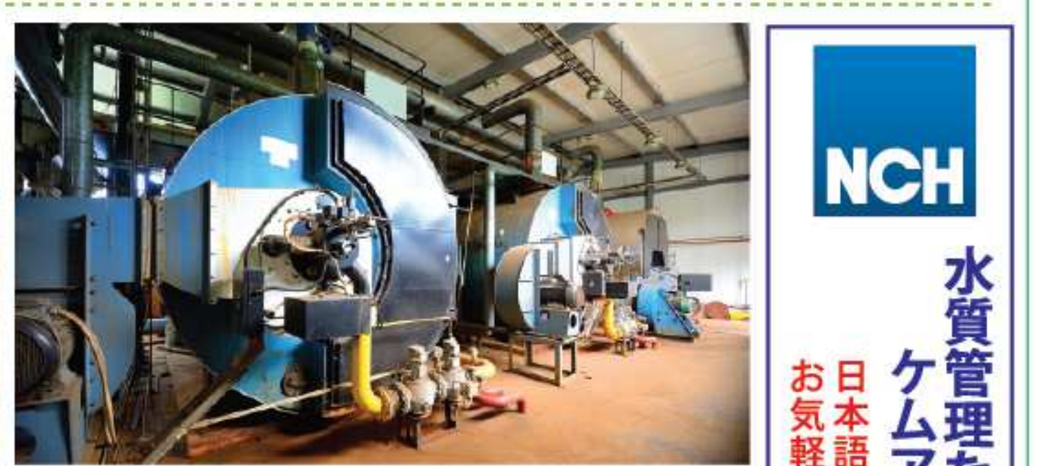
ボイラーの水質管理
