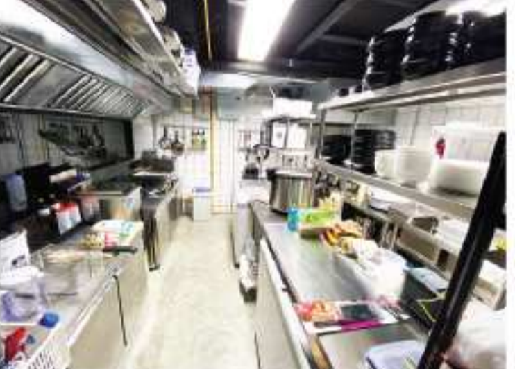
排気ダクト、ガス設備、製氷機配置 (製氷排水敷設) など、シェフのご要望通り設計・施工致します。
