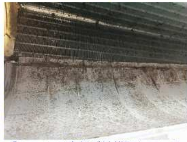
②ファンの裏側が結構汚れている
