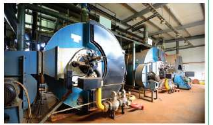
ボイラーの水質管理
