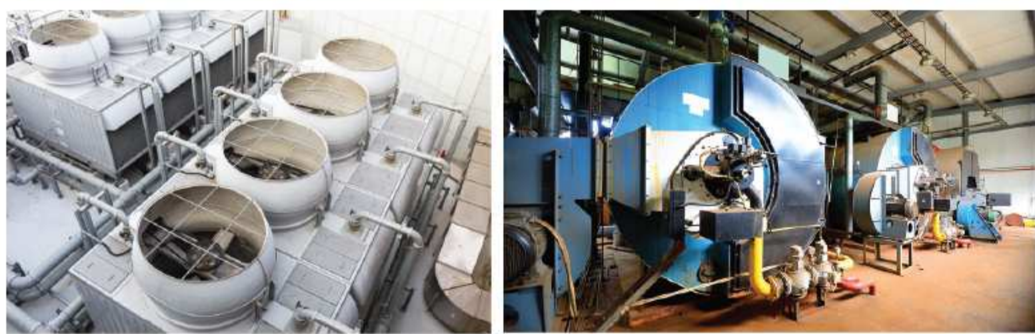
冷却塔の水質管理もお任せください ボイラーの水質管理
