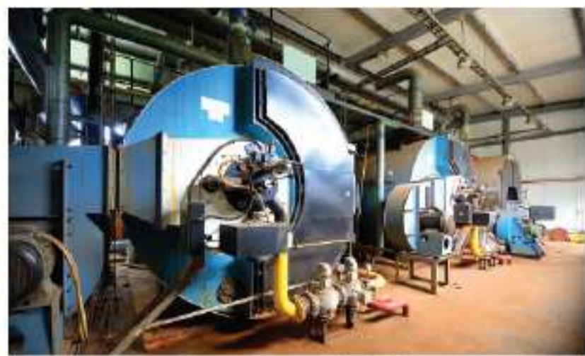
ボイラーの水質管理
