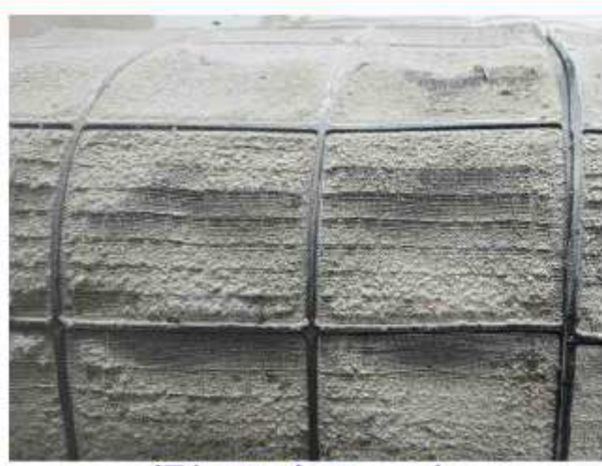
汚れていたフィルター
